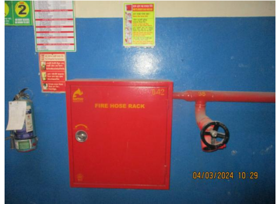
Fire hose pipe.JPG
