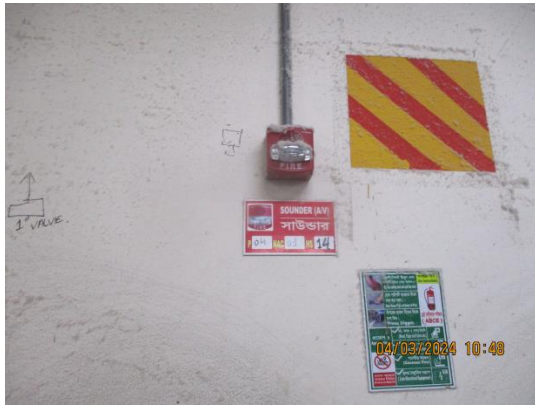
Fire alarm sounder.JPG
