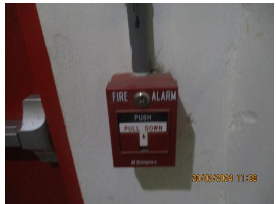
Fire alarm switch.JPG
