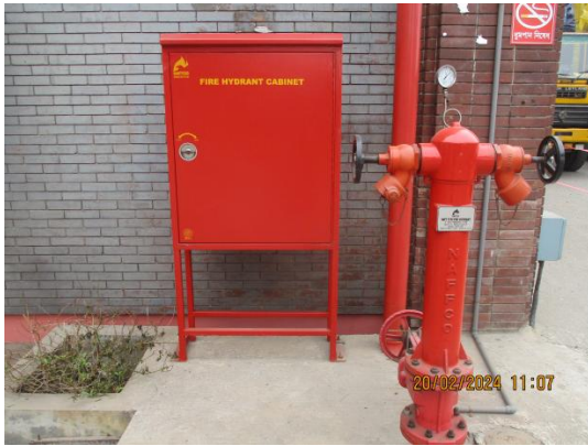
Fire hose cabinet.JPG
